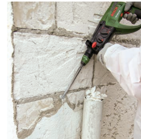
2 Mürbe Mauerwerksfugen 2 bis 3 cm tief auskratzen, anschließend die Fläche abfegen oder absaugen; nicht mit Wasser reinigen, da sich so erneut Salze lösen
