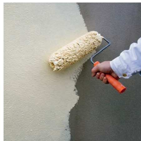
2 Alternativ: Streichen des Sanierputzes
