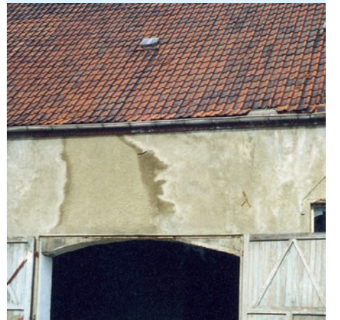
Feuchteschaden im Dachbereich
