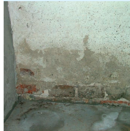
Feuchteschaden im Keller
